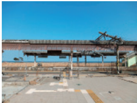
津波により崩壊したJR富岡駅
