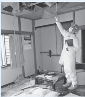
雨漏りと小動物の糞尿で荒廃が進む居住制限区域内の家屋
