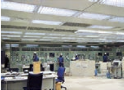
津波到達後の中央制御室の様子
