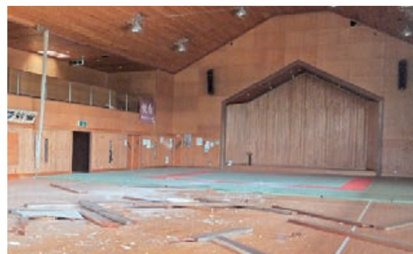
天井の梁が落下した富岡町武道館
