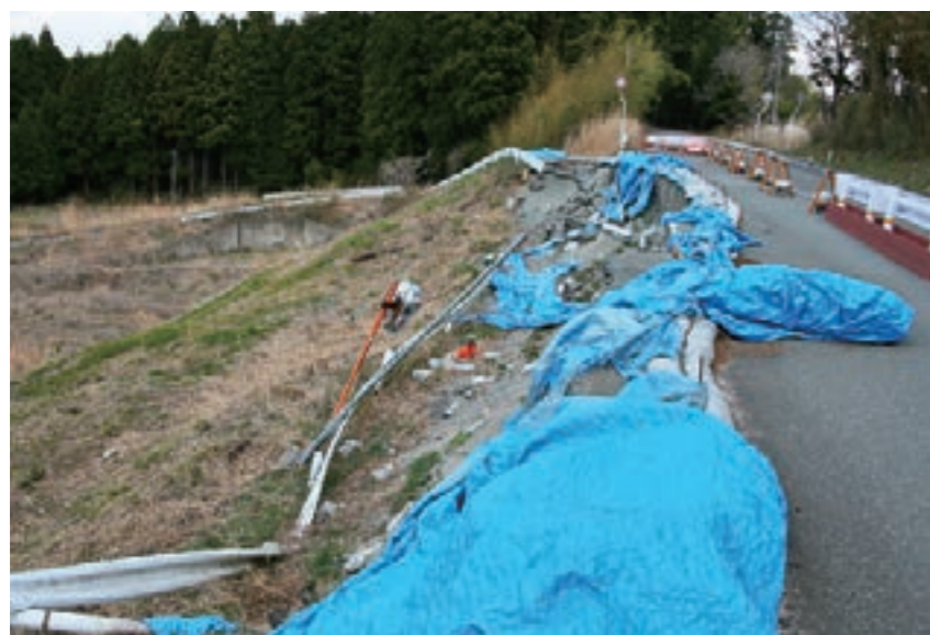
避難路も大きな被害を受けた(県道35号線※山麓線)
