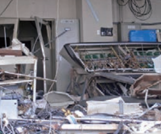
富岡浄化センター
