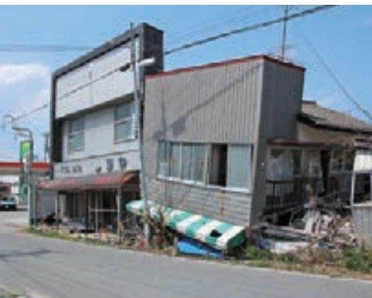
倒壊した店舗
