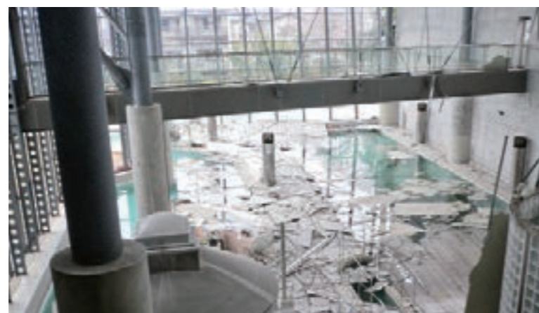
天井が落下したリフレ富岡
