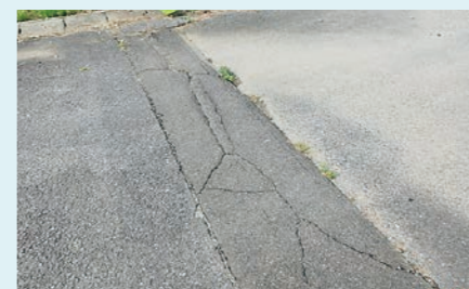
町内の道路のクラック ※現在は補修が完了
