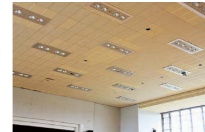
3月の地震で損傷を受けた総合体育館(当面の間 利用不可)
