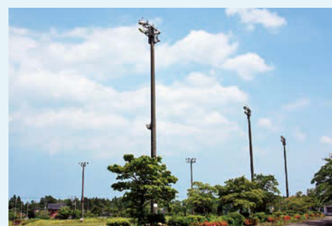
総合グラウンドの照明施設
