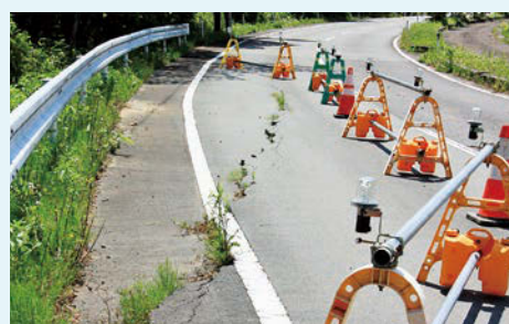
復旧を待つ、町道・桜王塚線
