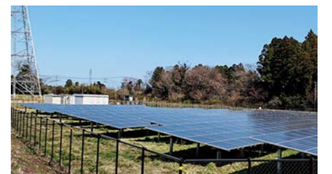
町内の太陽光発電施設
