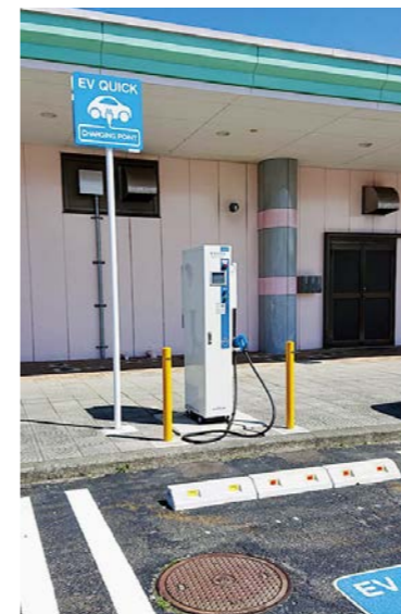
EV充電スタンド(さくらモール駐車場)
