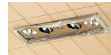
地震でずれた体育館照明
