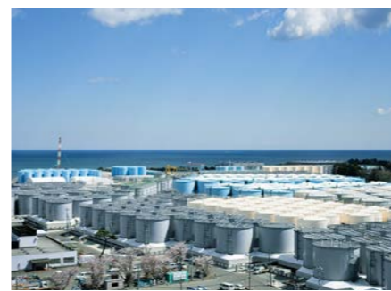
第一原発敷地内の処理水タンク群
