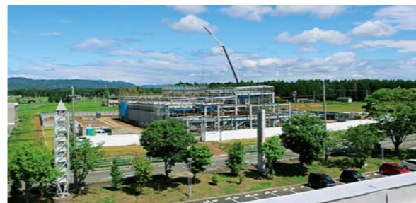
生涯学習での活用が期待されるアーカイブ施設(建設中)
