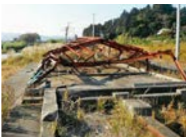
津波で被災した鮭増殖場(解体済)
