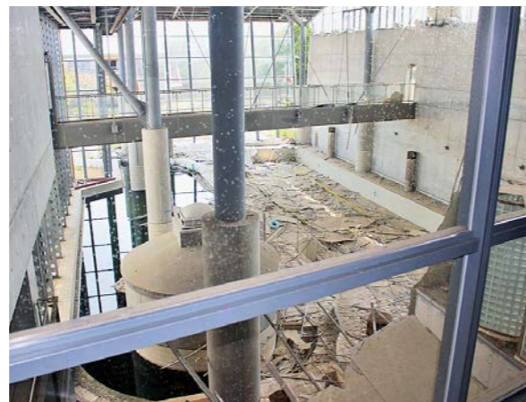
天井の落ちているプール
