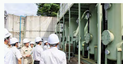
浸出水処理施設
