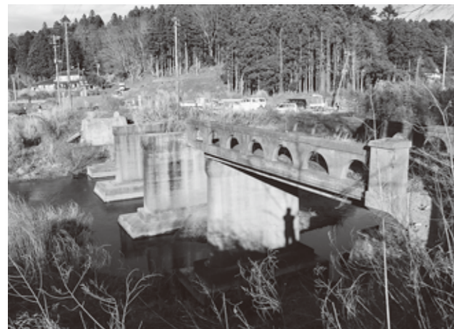
流出した小浜橋の現況
