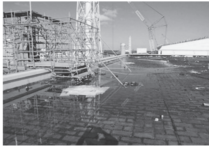
建物屋上の雨水状況
