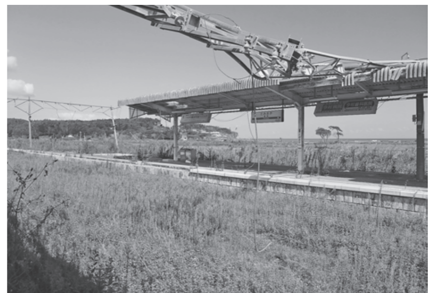
津波の被災を受けた富岡駅。復旧の見込みはまだみえない。
