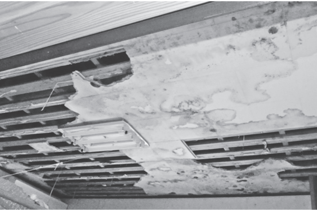
判定は一部損壊だが、屋内は雨漏りなどによる荒廃が進む
