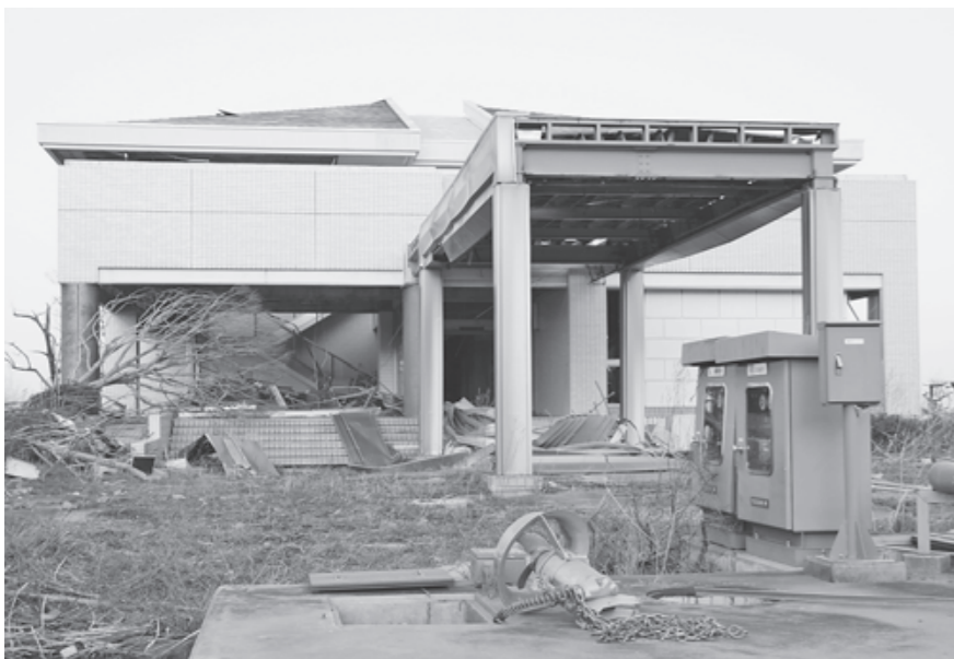
富岡浄化センター
