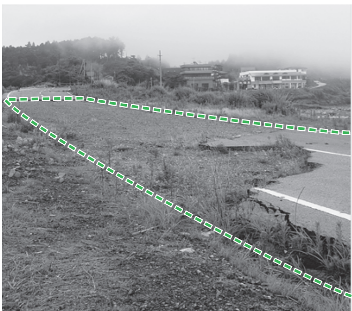
津波被害を受けた県道広野小高線
