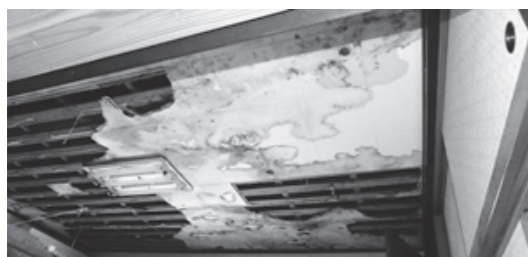
雨漏りにより天井が腐食した一般住宅
