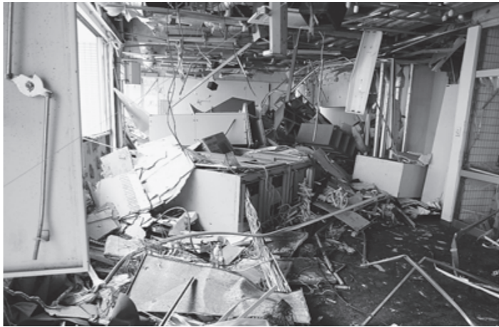
全喪失した機器類
