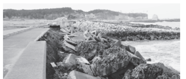
東日本大震災による大津波で壊れた防波堤
