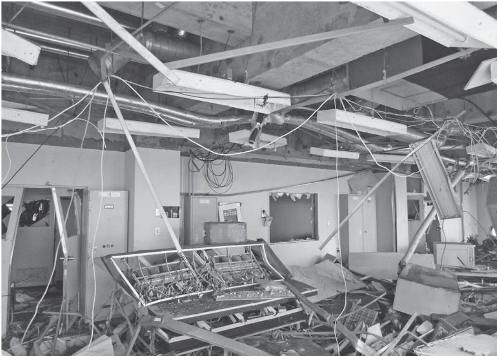
富岡浄化センター内部
