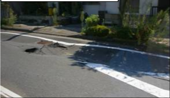
地震により陥没した道路
