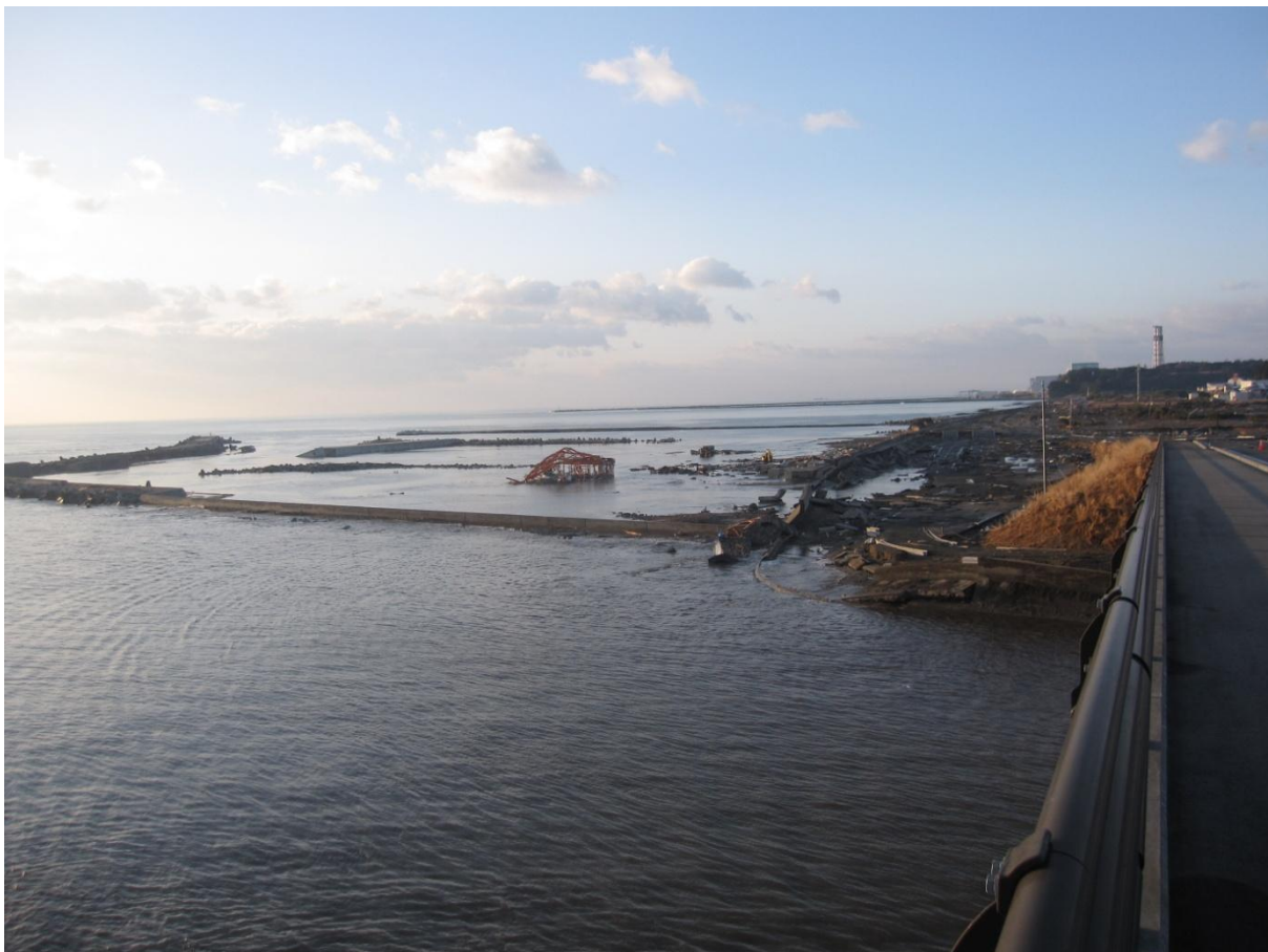
富岡漁港施設の被災状況 全施設津波流失
