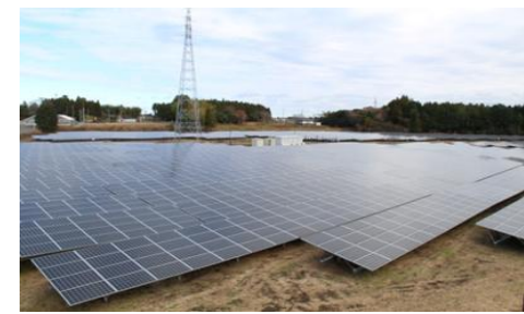
増加する太陽光発電設備
