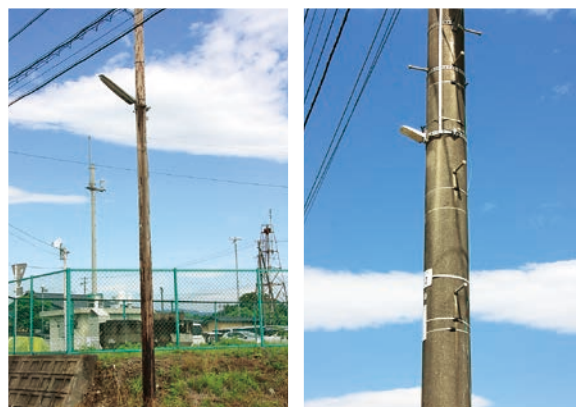
今回更新対象の照明（一部） 老朽化した独立柱（左）のタイプについては 撤去移設の対応も行う
