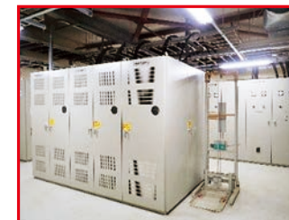
文化交流センター電気室
