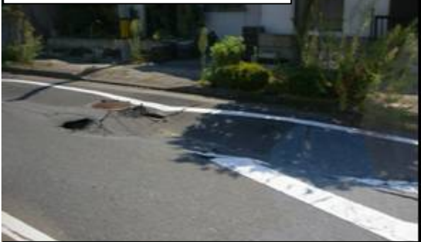
地震により陥没した道路
