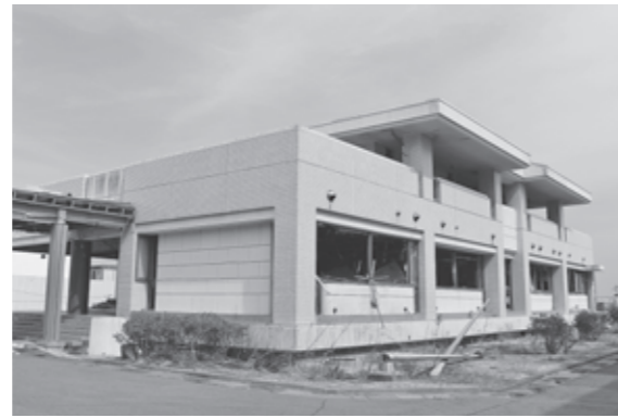
復旧が急がれる富岡浄化センター
